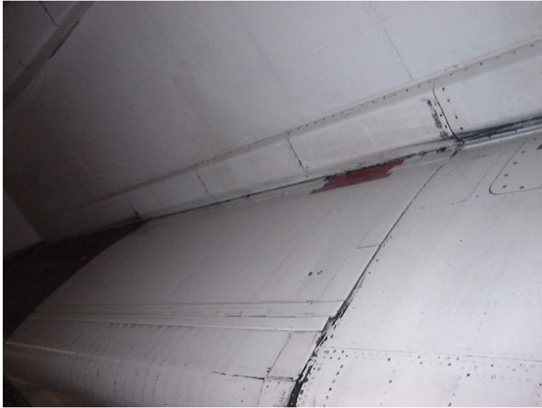
Figure 65 : En rouge, trappe de prise d'air latérale d'alimentation des échangeurs de climatisation
